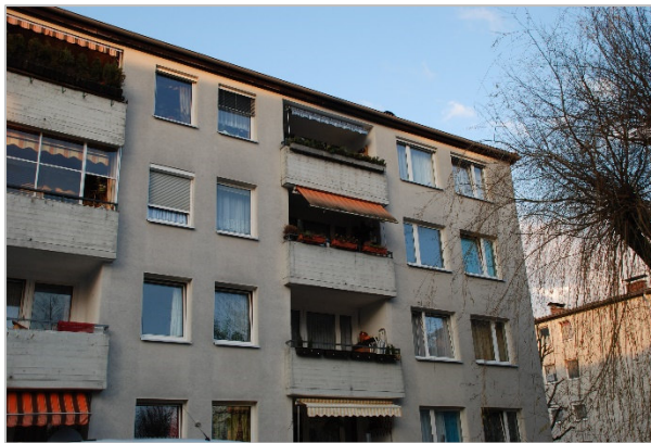
VOR der Sanierung – abgewohnt & wenig einladend. © SIR
