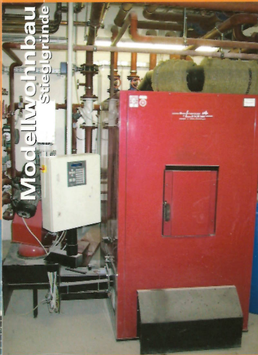
Zwei 150-kW-Pelletsessel versorgen die ganze Anlage mit umweltfreundlicher Wärme und Heißwasser.
