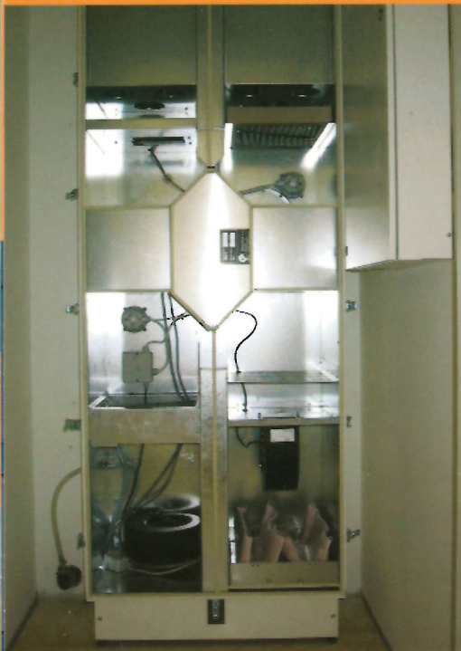
Die Lüftungseinheit je Wohnung mit dem Wärmetauscher in der Mitte sorgt für temperierte Frischluft in den Wohn- und Schlafräumen.
