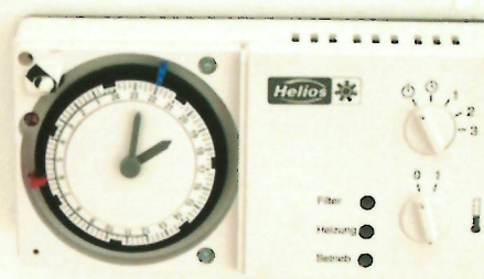
Das Bedienelement in den Wohnungen für Heizung und Lüftung.
